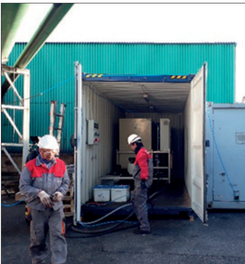
225 Pilotanlage zur Entsalzung
